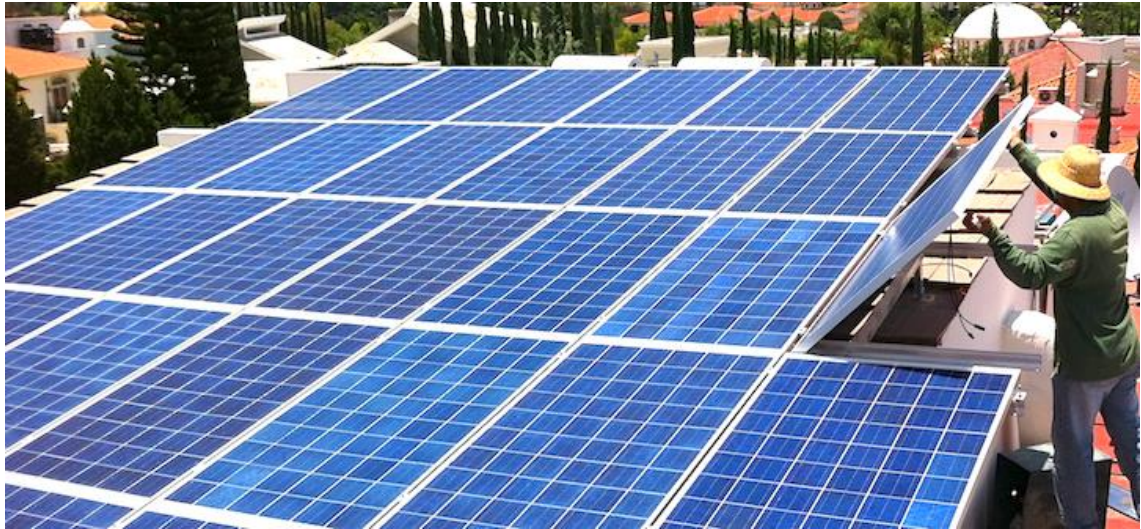
Ilustración 1. Instalación residencial (Solar Berater)
